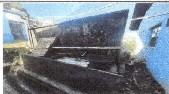
Foto 7: El depósito de Agua No. 1 está en mal estado necesita repello por dentro. Los tres chorros y el lavamanos en mal estado.
