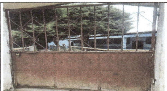
Foto 9: el portón de la entrada está dañado en sus bisagras y la lámina ya está muy dañada, necesita pintura y arreglar el lugar del candado.
