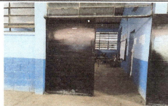
Foto 4: piso del Aula 4 Segundo C, se encuentra dañado con agujeros y es piso de concreto rústico.
