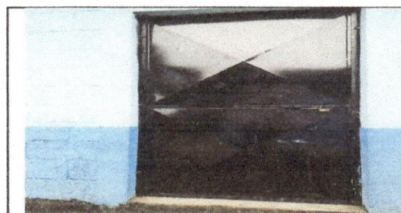
Foto 12: La puerta de la bodega no sirve, debido a que el marco se dañó igual que las bisagras.
